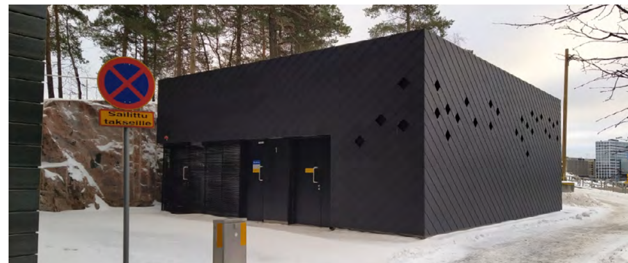
Kuvat 30-31: Esimerkkejä toteutuneista sähkönsyöttöasemista Helsingissä.
